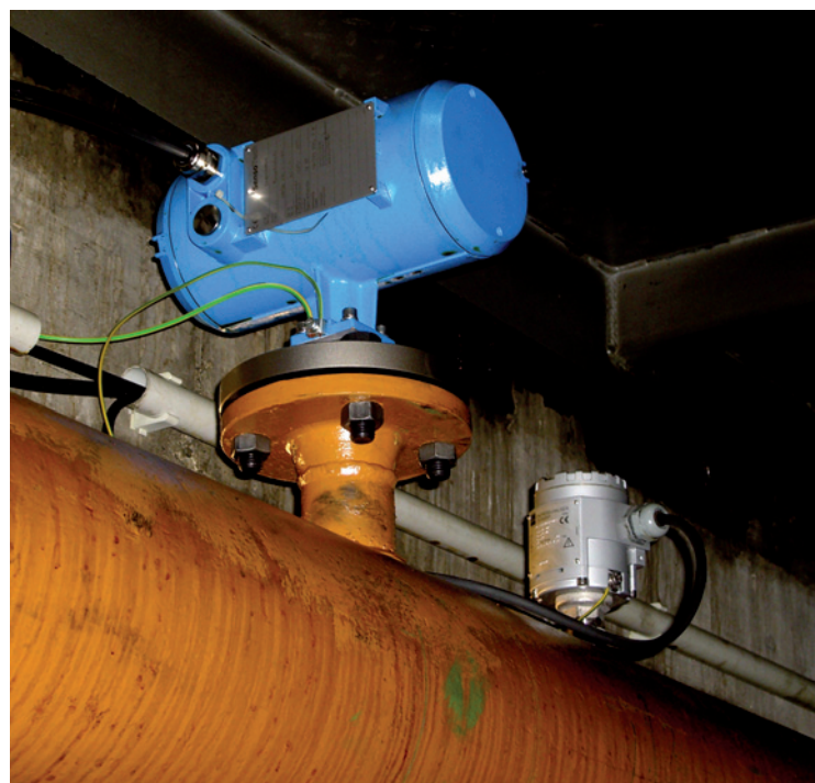
Ein LiquiSonic-Sensor an der Zuleitung zu einem Aggregat
