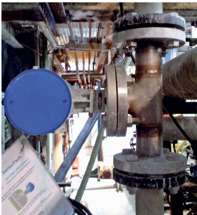
Abb. 3: Eingebauter LiquiSonic-Tauchsensoren in der Beizanlage der Amag
